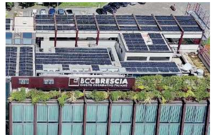
Sostenibilità. I pannelli fotovoltaici installati sul tetto della sede di Nave
